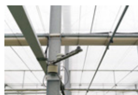
光照度環控偵測設備。
