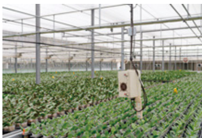
溫溼度環控偵測設備。
